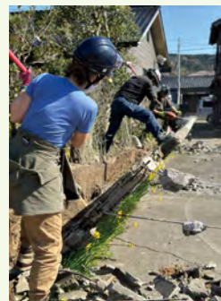
能登半島地震で被災された民家のブロック塀の解体・撤去
